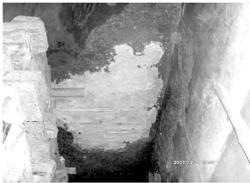
(b) 混凝土发生多层剥落
