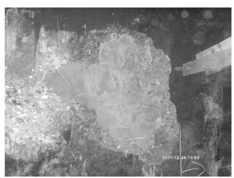
图 2 墩台身受损情况
