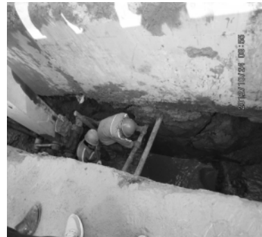
图 7 漏浆时浅层整体塌陷
