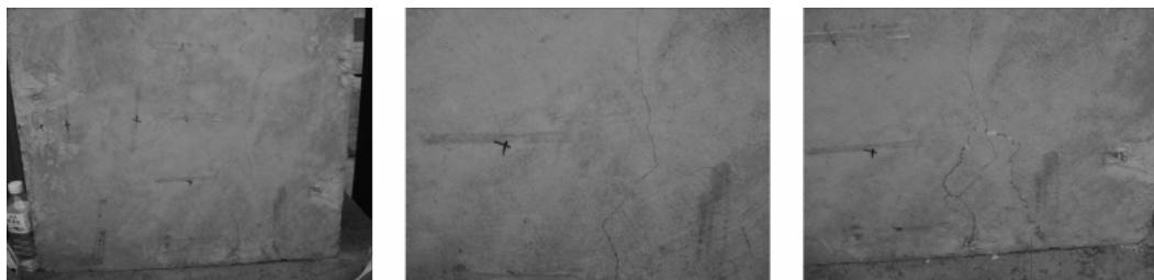
图6 推出件混凝土裂缝发展图
