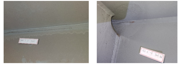
图16 实桥顶板焊根贯穿裂纹
