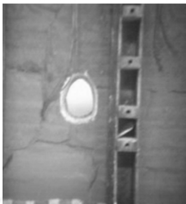
图 21 隧道剪切破坏状态
