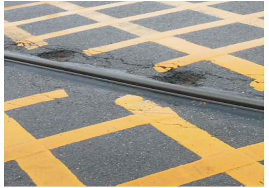
图 4 扣件顶部路面开裂与破损
