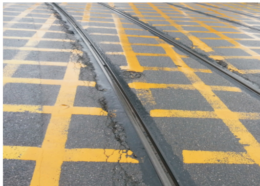
图 1 轨道周围路面开裂与破损
