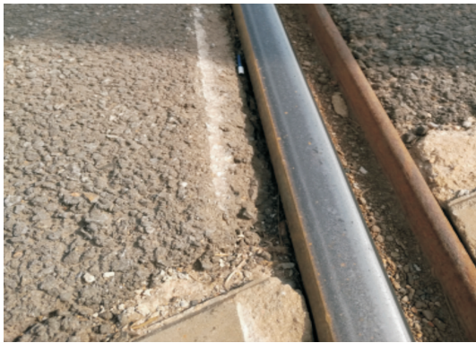
图 5 道路上的轨面沉降
